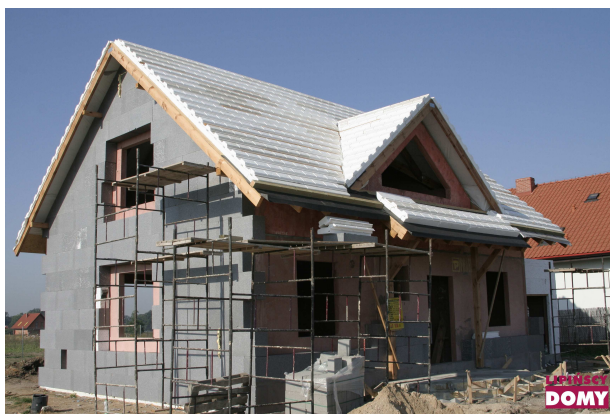
Rys. 4 Izolacja ścian zewnętrznych wykonana z 30 cm szarego styropianu oraz styropianowe panele dachowe.
