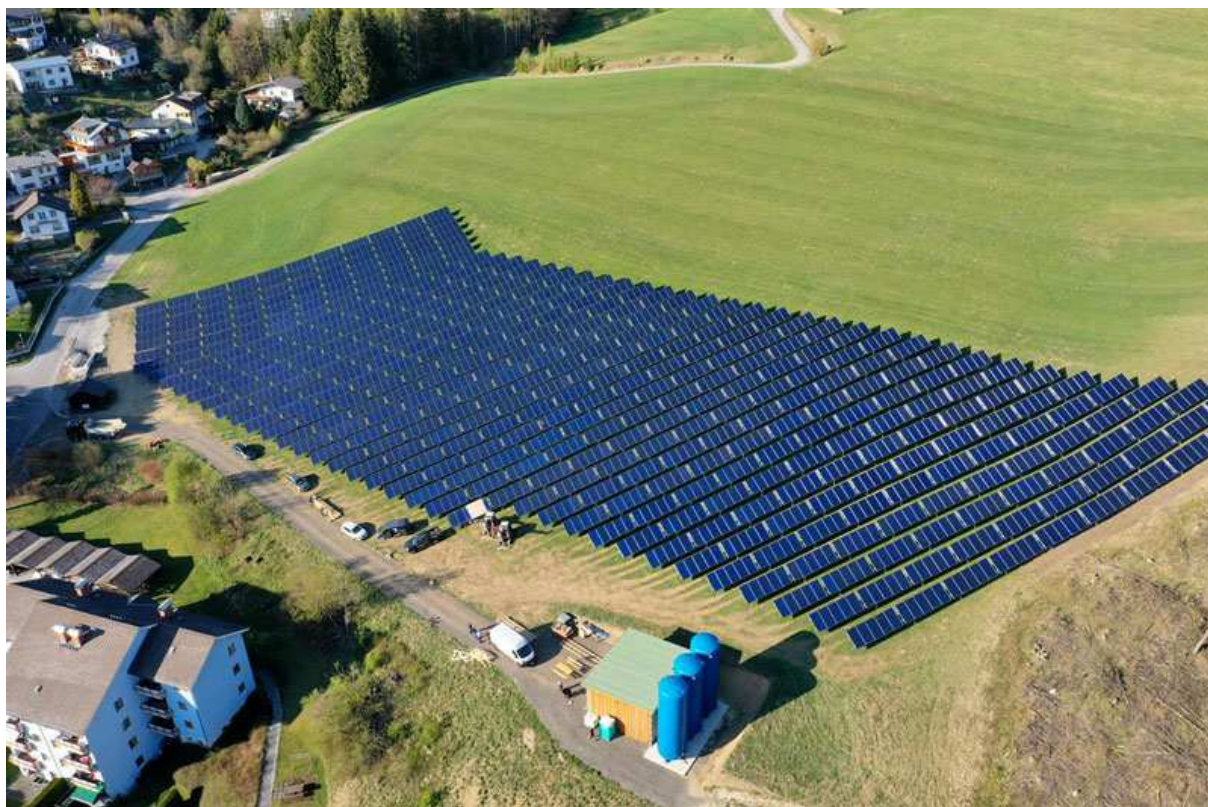
Rys. 7 Przykłady montażu kolektorów słonecznych na gruncie - System kolektorów słonecznych o powierzchni 5000 metrów kwadratowych w Mürzzuschlag w Styrii/Austria.
